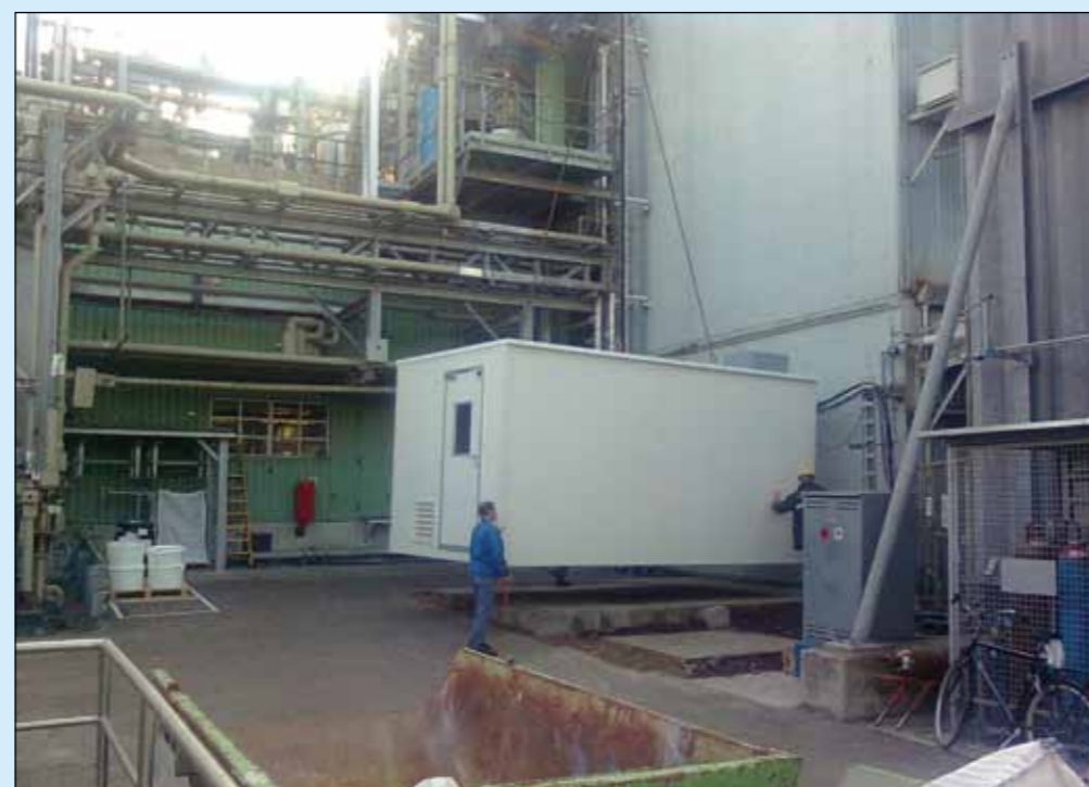
De skid kwam door plaatsgebrek buiten het pand te staan.
